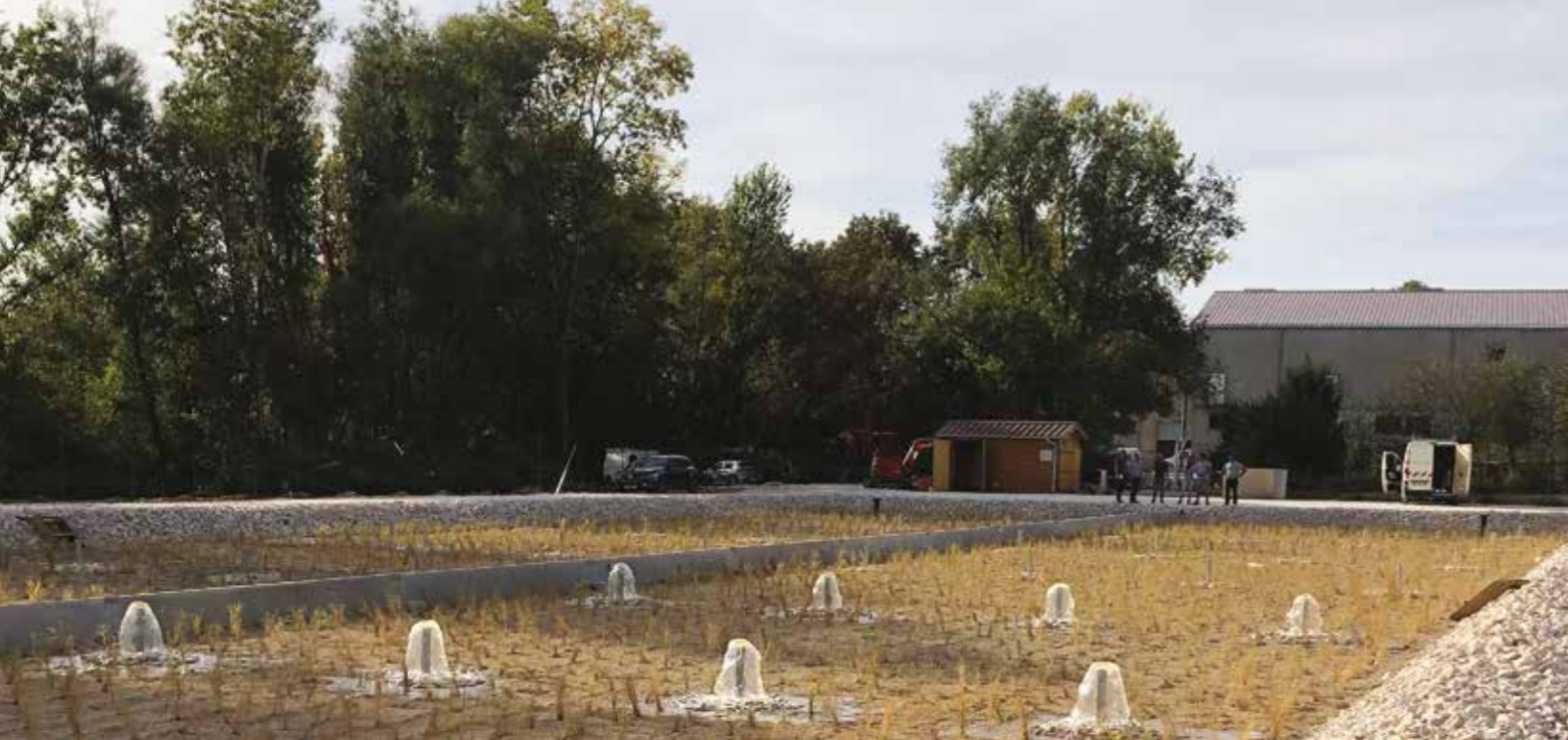
La nouvelle station d'épuration « rhizosph'air » à Orchamps a été mise en service récemment.
