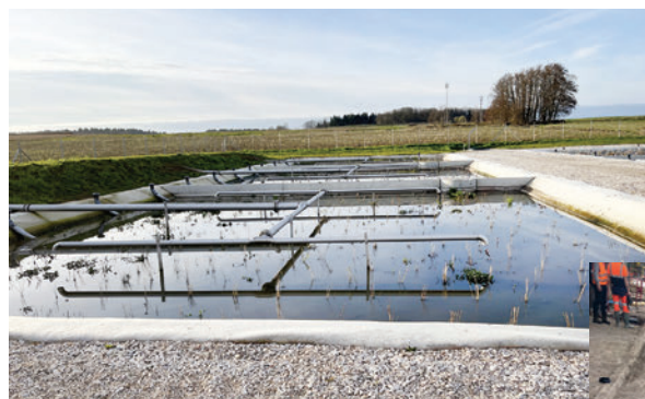
Nouvelle station d'épuration filtres plantés de roseaux
